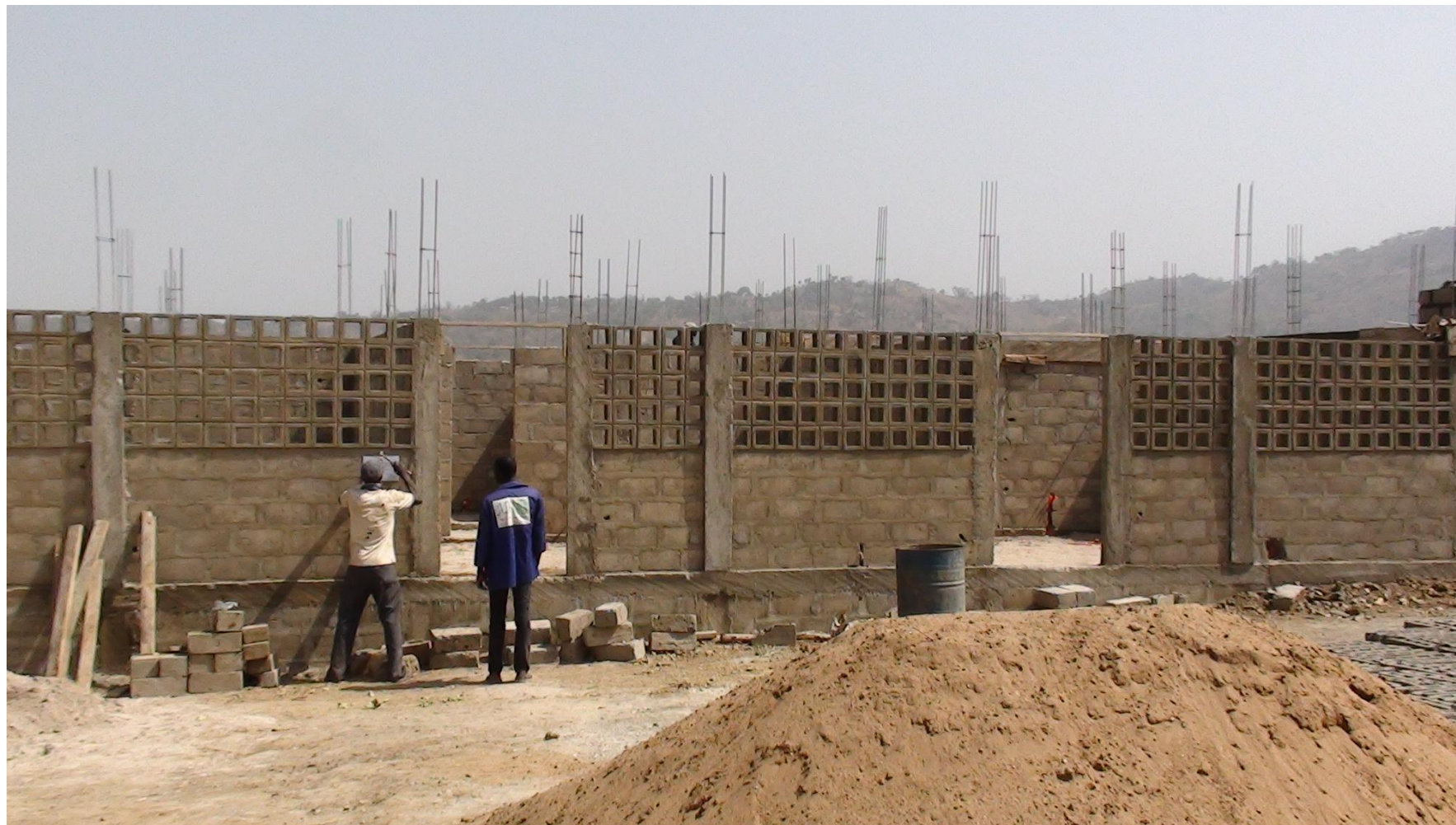
Prima fase costruzione: La Scuola Professionale Agricola in Costruzione nel Cantone di Tcharè in TOGO.
